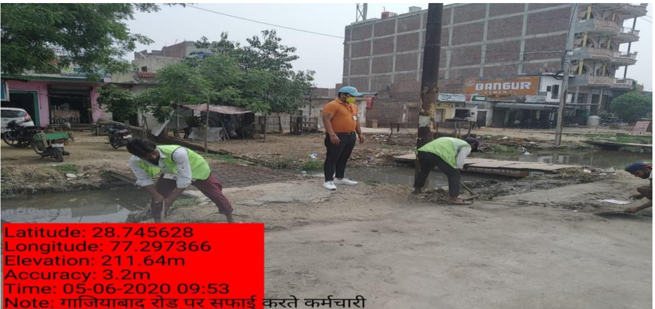
Latitude: 28.745662 Longitude: 77.297468 Elevation: 207.89m Accuracy: 3.2m Time: 05-06-2020 09:53 Note: गाजियाबाद रोड पर सफाई करते कर्मचारी
